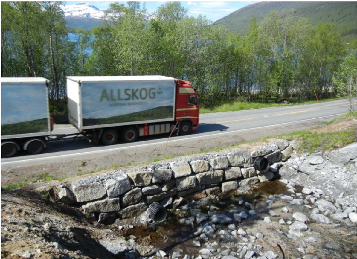
Figur 45: Fangmagasin/skredbasseng mot sørpeskred, eksempel fra E6 Sandnesbotn i Nordland. Ofte føres bekk i et betydelig større rør enn vist på foto, eller i kulvert gjennom vegen. Et rør nr. 2 som overløpsrør er også viktig, vist til høyre i foto. (Foto: Therese Sigurdson, SVV).
